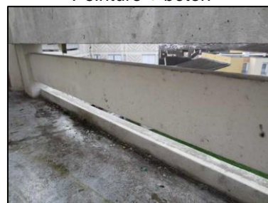
Photo N° 73 ECH-N°071B Bâtiment 21-4ème-Appartement 21041 Balcon – APT21041 – Soubassement Peinture + béton
