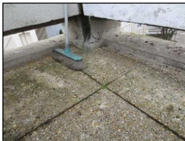
Photo N° 18 ECH-N°017 Bâtiment 1-4ème-Appartement 1041 Terrasse – Bac soubassement Béton + peinture
