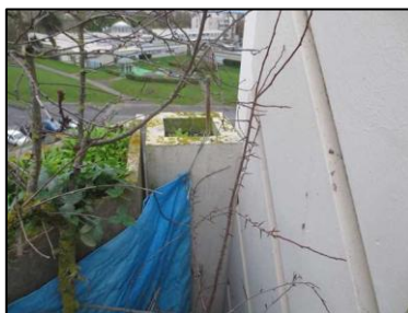
Photo N° 89 ECH-N°087B Bâtiment 30-6ème-Appartement 30062 Balcon – APT30062 – 2 Bacs Peinture + béton
