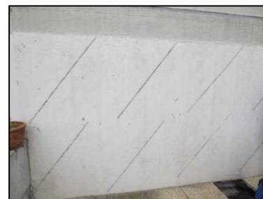
Photo N° 9 ECH-N°008 Bâtiment 19-4ème-Appartement 19042 Terrasse - Mur Béton + peinture
