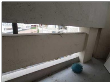
Photo N° 54 ECH-N°052B Bâtiment 19-3ème-Appartement 19034 Balcon - APT19034 – Soubassement Peinture + béton
