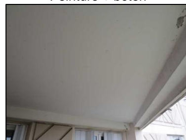
Photo N° 48 ECH-N°046B Bâtiment 30-1er-Appartement 30011 Balcon – APT30011 – Plafond Peinture + béton
