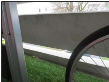
Photo N° 101 ECH-N°099B Bâtiment 30-2ème-Appartement 30022 Balcon – APT30022 – Soubassement Peinture + béton
