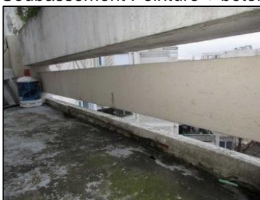
Photo N° 709 ECH-N°155B Bâtiment 28-4ème-Appartement 28042 Balcon – APT28042 – Soubassement Peinture + béton
