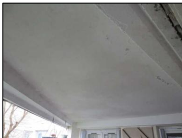
Photo N° 165 ECH-N°019B Bâtiment 1-1er-Appartement 1013 Balcon – APT1013 – Plafond Peinture + béton
