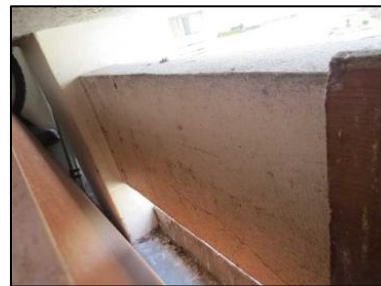
Photo N° 136 ECH-N°135B Bâtiment 5-4ème-Appartement 5042 Balcon – APT5042 – Soubassement Peinture + béton
