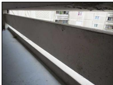
Photo N° 85 ECH-N°083B Bâtiment 19-2ème-Appartement 19025 Balcon - APT19025 – Soubassement Peinture + béton
