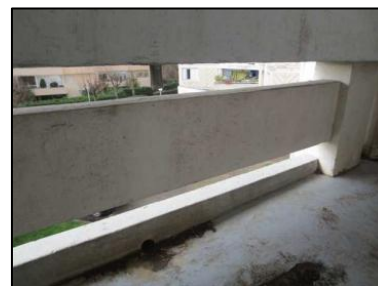
Photo N° 144 ECH-N°143B Bâtiment 7-2ème-Appartement 7025 Balcon – APT7025 – Soubassement Peinture + béton
