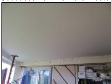
Photo N° 60 ECH-N°058B Bâtiment 19-1er-Appartement 19012 Balcon - APT19012 – Plafond Peinture + béton
