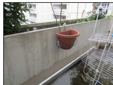
Photo N° 111 ECH-N°110B Bâtiment 32-3ème-Appartement 32032 Balcon – APT32032 – Bac centre Peinture + béton
