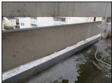
Photo N° 112 ECH-N°111B Bâtiment 32-3ème-Appartement 32032 Balcon – APT32032 - Soubassement Peinture + béton
