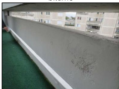
Photo N° 82 ECH-N°080B Bâtiment 19-4ème-Appartement 19041 Balcon - APT19041 – Soubassement Peinture + béton
