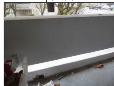
Photo N° 152 ECH-N°006B Bâtiment 1-2ème-Appartement 1022 Balcon - APT1022 - Soubassement Peinture + béton
