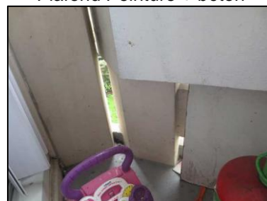
Photo N° 50 ECH-N°048B Bâtiment 30-2ème-Appartement 30024 Balcon – APT30024 – Soubassement Peinture + béton
