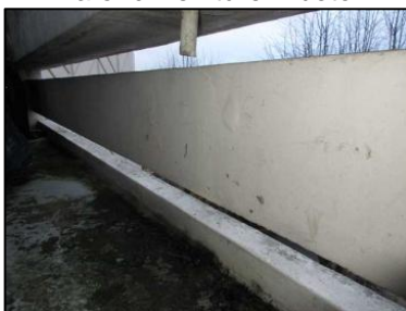
Photo N° 706 ECH-N°152B Bâtiment 28-3ème-Appartement 28033 Balcon – APT28033 – Soubassement Peinture + béton
