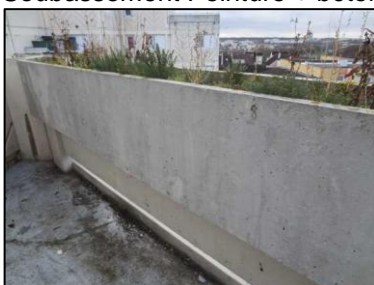
Photo N° 72 ECH-N°070B Bâtiment 21-4ème-Appartement 21041 Balcon – APT21041 – Bac centre Peinture + béton
