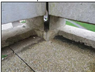
Photo N° 27 ECH-N°026 Bâtiment 7-2ème-Appartement 7022 Terrasse – Bac soubassement Béton + peinture
