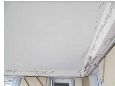
Photo N° 169 ECH-N°023B Bâtiment 7-1er-Appartement 7011 Balcon – APT7011 – Plafond Peinture + béton
