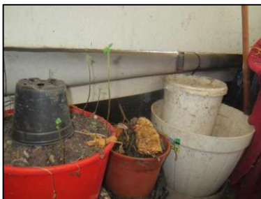
Photo N° 140 ECH-N°139B Bâtiment 5-3ème-Appartement 5031 Balcon – APT5031 – Soubassement Peinture + béton
