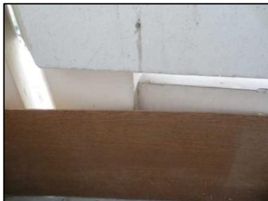
Photo N° 104 ECH-N°103B Bâtiment 30-3ème-Appartement 30035 Balcon – APT30035 – Soubassement Peinture + béton
