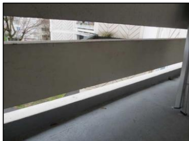
Photo N° 65 ECH-N°063B Bâtiment 32-2ème-Appartement 32021 Balcon – APT32021 – Soubassement Peinture + béton
