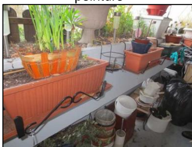
Photo N° 163 ECH-N°016B Bâtiment 1-1er-Appartement 1013 Balcon – APT1013 – Bac Peinture + béton
