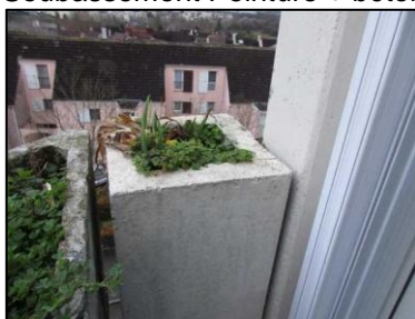
Photo N° 711 ECH-N°157B Bâtiment 28-4ème-Appartement 28042 Balcon – APT28042 – 2 Bacs Peinture + béton
