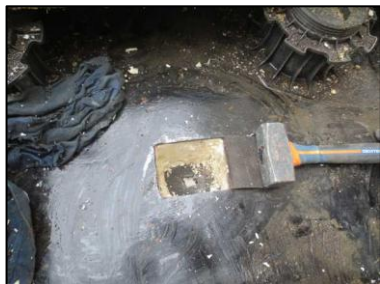
Photo N° 8 ECH-N°007 Bâtiment 19-4ème-Appartement 19042 Terrasse - Etanchéité Mousse + bitume
