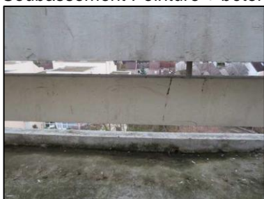
Photo N° 93 ECH-N°091B Bâtiment 3-5ème-Appartement 3054 Balcon – APT3054 – Soubassement Peinture + béton
