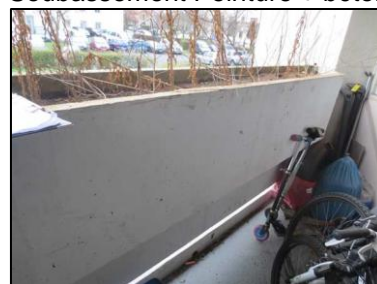
Photo N° 76 ECH-N°074B Bâtiment 21-1er-Appartement 21012 Balcon – APT21012 – Bac Peinture + béton
