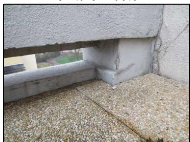
Photo N° 6 ECH-N°005 Bâtiment 19-4ème-Appartement 19042 Terrasse - Bac soubassement Béton + peinture
