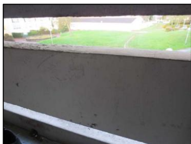
Photo N° 120 ECH-N°119B Bâtiment 19-2ème-Appartement 19023 Balcon - APT19023 – Soubassement Peinture + béton
