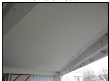
Photo N° 118 ECH-N°117B Bâtiment 21-1er-Appartement 21013 Balcon – APT21013 – Plafond Peinture + béton
