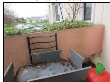
Photo N° 61 ECH-N°059B Bâtiment 32-1er-Appartement 32014 Balcon – APT32014 – Bac Peinture + béton
