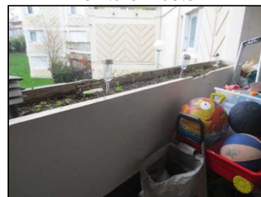
Photo N° 158 ECH-N°012B Bâtiment 3-1er-Appartement 3012 Balcon – APT3012 – Bac Peinture + béton
