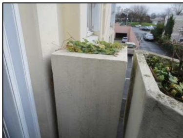
Photo N° 69 ECH-N°067B Bâtiment 21-1er-Appartement 21014 Balcon – APT21014 – 2 Bacs Peinture + béton
