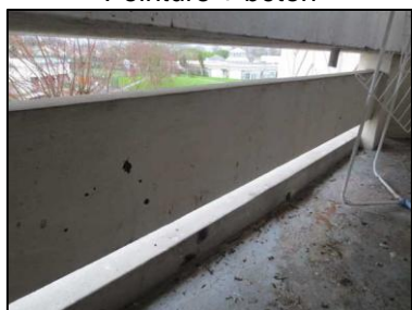
Photo N° 148 ECH-N°002B Bâtiment 32-3ème-Appartement 32034 Balcon - APT32034 - Soubassement Peinture + béton
