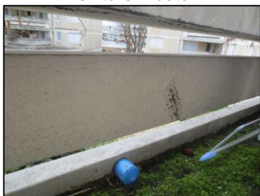
Photo N° 156 ECH-N°010B Bâtiment 3-2ème-Appartement 3025 Balcon – APT3025 - Soubassement Peinture + béton
