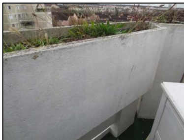
Photo N° 80 ECH-N°078B Bâtiment 19-4ème-Appartement 19041 Balcon – APT19041 – Bac centre Peinture + béton
