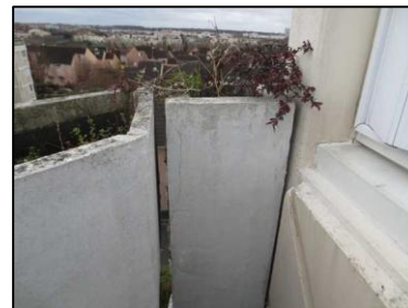
Photo N° 81 ECH-N°079B Bâtiment 19-4ème-Appartement 19041 Balcon - APT19041 – 2 Bacs Peinture + béton
