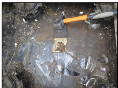
Photo N° 11 ECH-N°010 Bâtiment 30-6ème-Appartement 30063 Terrasse – Etanchéité Mousse + bitume
