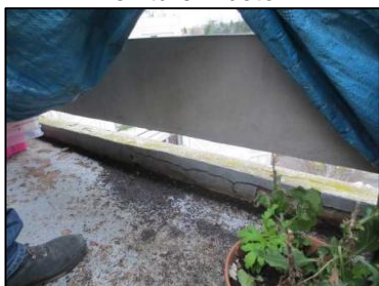
Photo N° 90 ECH-N°088B Bâtiment 30-6ème-Appartement 30062 Balcon – APT30062 – Soubassement Peinture + béton
