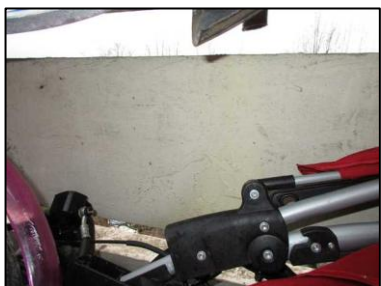
Photo N° 713 ECH-N°159B Bâtiment 1-3ème-Appartement 1035 Balcon - APT1035 – Soubassement Peinture + béton
