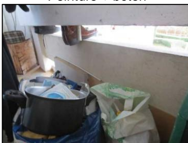
Photo N° 97 ECH-N°095B Bâtiment 3-2ème-Appartement 3023 Balcon – APT3023 – Soubassement Peinture + béton
