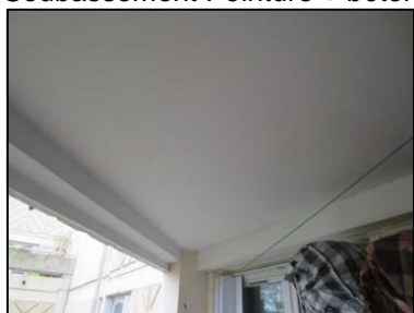
Photo N° 162 ECH-N°015B Bâtiment 3-1er-Appartement 3012 Balcon – APT3012 – Plafond Peinture + béton
