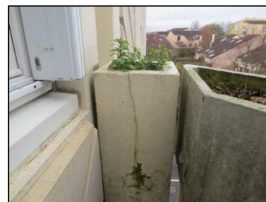
Photo N° 42 ECH-N°040B Bâtiment 28-3ème-Appartement 28034 Balcon – APT2834 – 2 Bacs Peinture + béton
