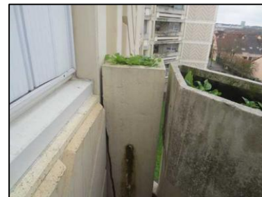
Photo N° 114 ECH-N°113B Bâtiment 32-3ème-Appartement 32032 Balcon – APT32032 – 2 Bacs Peinture + béton
