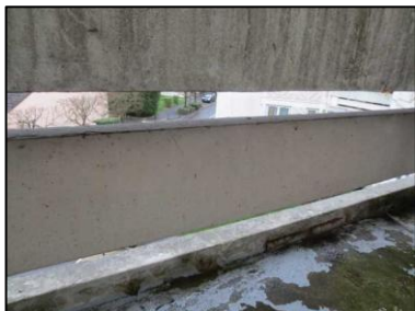
Photo N° 43 ECH-N°041B Bâtiment 28-3ème-Appartement 28034 Balcon – APT2834 – Soubassement Peinture + béton
