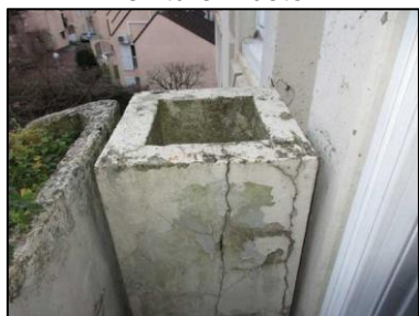
Photo N° 705 ECH-N°151B Bâtiment 28-3ème-Appartement 28033 Balcon – APT28033 – 2 Bacs Peinture + béton
