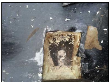
Photo N° 31 ECH-N°030 Bâtiment 32-5ème-Appartement 32052 Terrasse – Etanchéité Mousse + bitume
