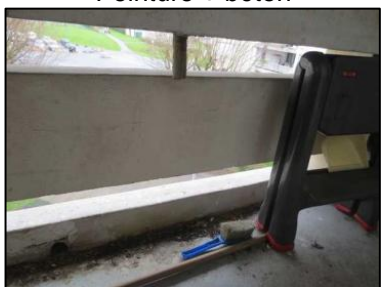
Photo N° 38 ECH-N°036B Bâtiment 28-3ème-Appartement 28035 Balcon – APT28035 – Soubassement Peinture + béton
