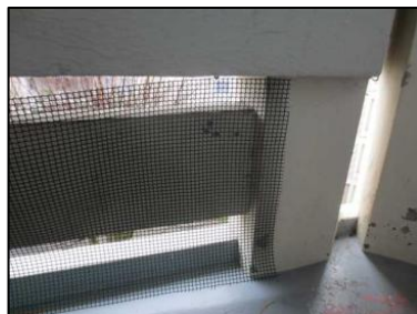
Photo N° 108 ECH-N°107B Bâtiment 30-3ème-Appartement 30033 Balcon – APT30033 – Soubassement Peinture + béton
