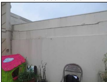
Photo N° 24 ECH-N°023 Bâtiment 7-2ème-Appartement 7022 Terrasse – Mur gauche Béton + peinture
