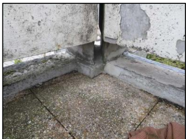
Photo N° 14 ECH-N°013 Bâtiment 30-6ème-Appartement 30063 Terrasse – Bac soubassement Béton + peinture
