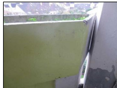
Photo N° 45 ECH-N°043B Bâtiment 30-1er-Appartement 30011 Balcon – APT30011 – Bac Peinture + béton
