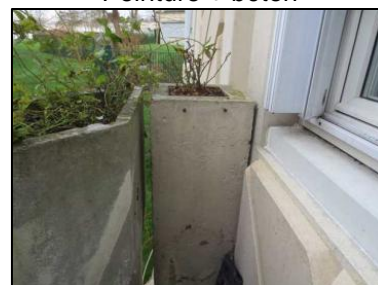
Photo N° 128 ECH-N°127B Bâtiment 7-1er-Appartement 7012 Balcon – APT7012 – 2 Bacs Peinture + béton
