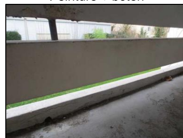
Photo N° 171 ECH-N°025B Bâtiment 7-2ème-Appartement 7023 Balcon – APT7023 – Soubassement Peinture + béton
