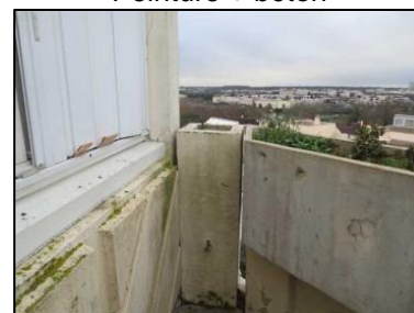
Photo N° 95 ECH-N°093B Bâtiment 3-5ème-Appartement 3054 Balcon – APT3054 – 2 Bacs Peinture + béton
