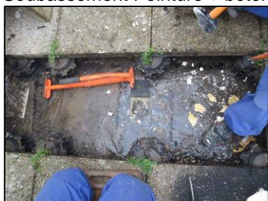
Photo N° 20 ECH-N°019 Bâtiment 1-4ème-Appartement 1041 Terrasse – Etanchéité Mousse + bitume
