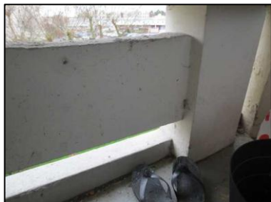
Photo N° 178 ECH-N°032B Bâtiment 5-3ème-Appartement 5033 Balcon – APT5033 – Soubassement Peinture + béton
