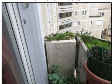
Photo N° 719 ECH-N°165B Bâtiment 1-3ème-Appartement 1034 Balcon - APT1034 – 2 Bacs Peinture + béton
