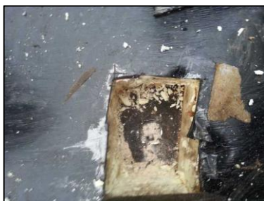
Photo N° 310 ECH-N°031 Bâtiment 32-5ème-Appartement 32052 Terrasse – Etanchéité sur dalle béton Etanchéité sur dalle béton
