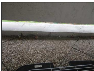
Photo N° 175 ECH-N°029B Bâtiment 5-2ème-Appartement 5024 Balcon – APT5024 – Soubassement Peinture + béton
