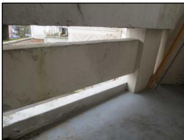
Photo N° 124 ECH-N°123B Bâtiment 1-2ème-Appartement 1021 Balcon - APT1021 – Soubassement Peinture + béton
