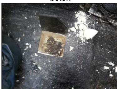
Photo N° 34 ECH-N°034 Bâtiment 21-4ème-Appartement 21043 Terrasse – Etanchéité Mousse + bitume
